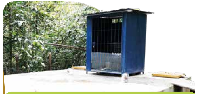
Tanque de almacenamiento Acueducto Pavitas
