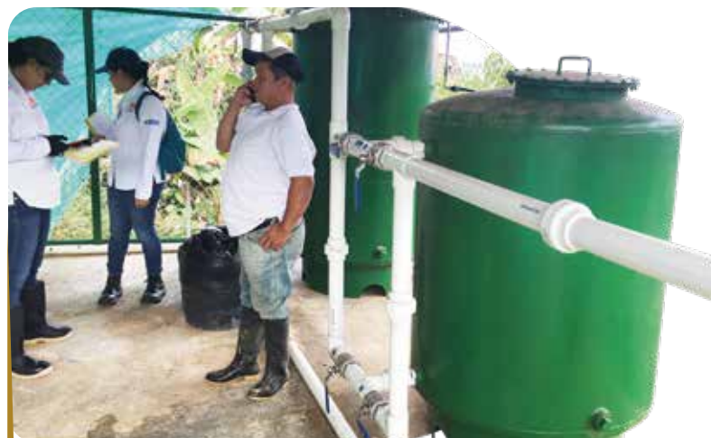
Planta de tratamiento Acueducto Arboledas - cordobitas.
